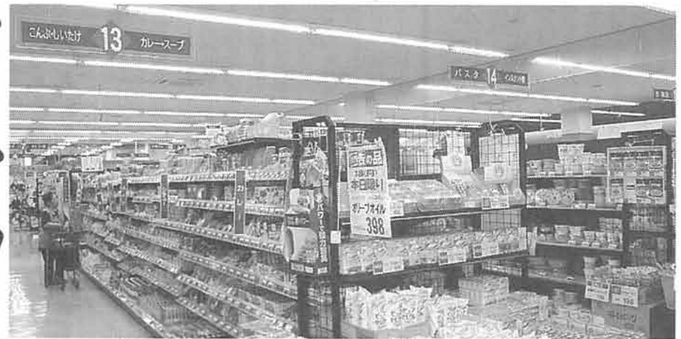
「Super RE-Light」を設置したスーパーの店内
